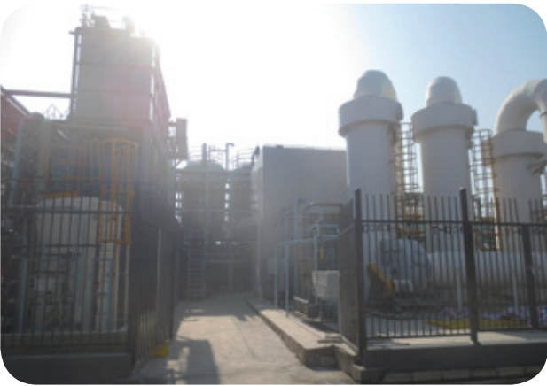
氨氮废水处理设施
