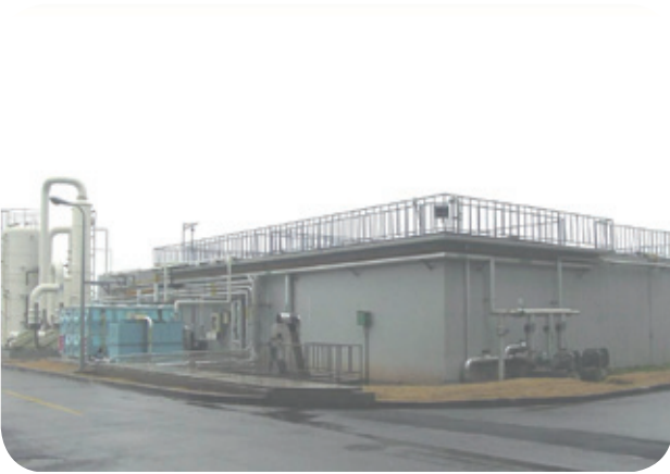
生活污水处理设施
